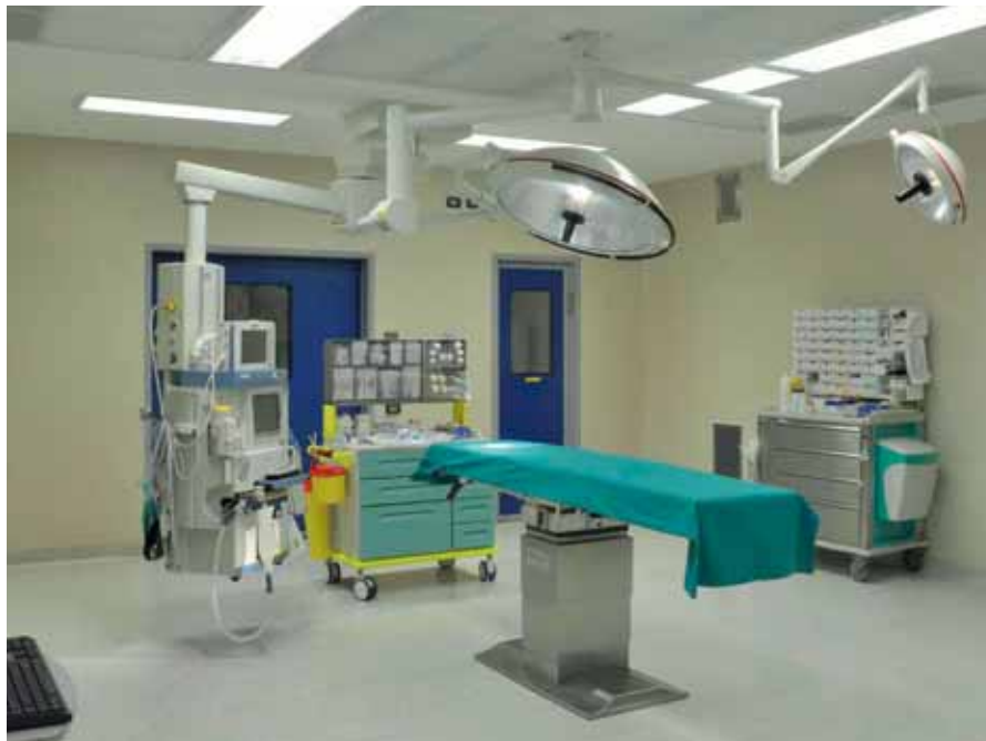
Den här operationssalen på Versilia-sjukhuset har taksystemet CamHosp R och uppfyller därmed de hårdaste luftkvalitetskraven för operationer.
